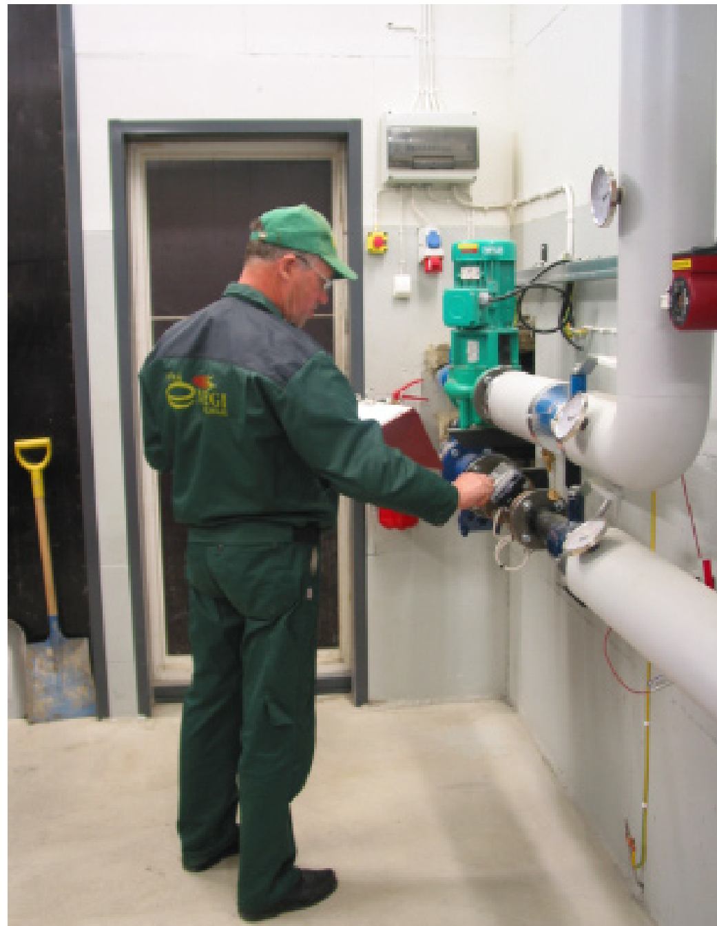
Kontroll av mätarställning i fliscentral, Vörå energiandelslag.
